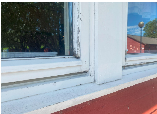
Bilde 3. Råteskade i vindu etter fuktinntrengning.
