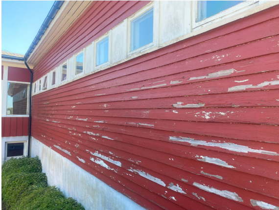
Bilde 1. Malingsslitasje og råte på trekledning.
