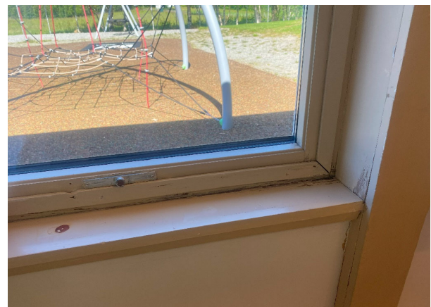
Bilde 4. Råteskade i vindu etter fuktinntrengning.
