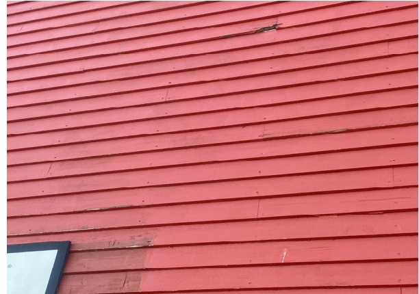
Bilde 2. Trekledning med malingsslitasje og råteskader.
