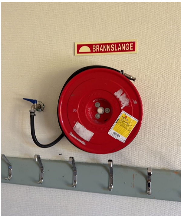
Bilde 16. Brannslange inngang bakside.
