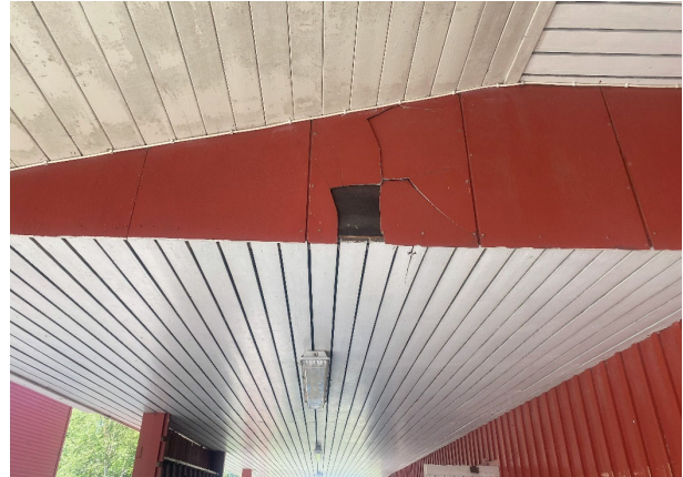
Bilde 2. Skade i antatt asbestholdig plate.
