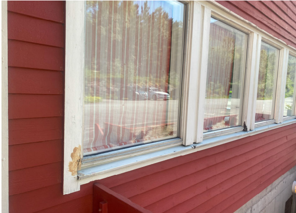
Bilde 1. Eldre vinduer med råteskader i karmen.
