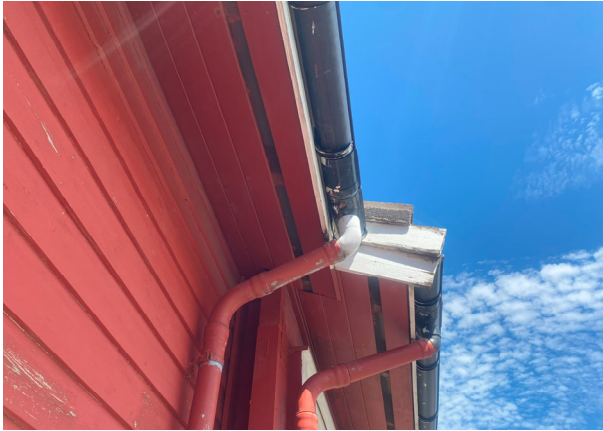
Bilde 5. Råteskader på vindskier og eldre takrenner/nedløp.
