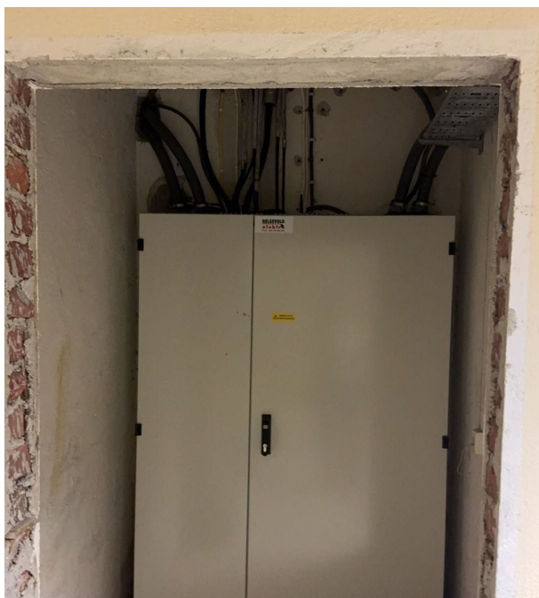
Bilde 11. Tavleskap i kjeller
