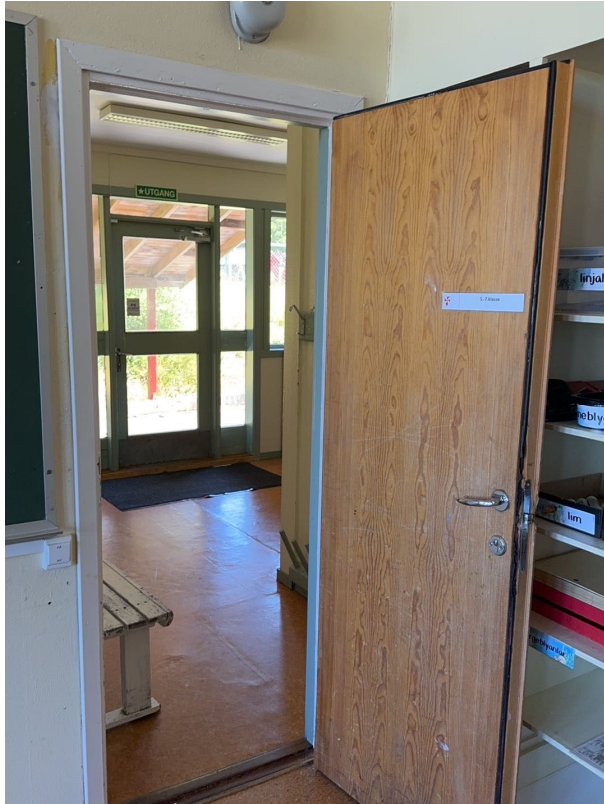
Bilde 8. Klasseromsdør feil vei
