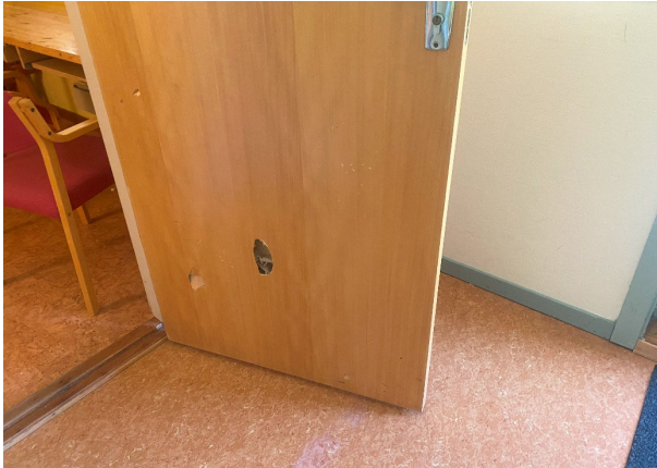
Bilde 5. Skader på innerdør.
