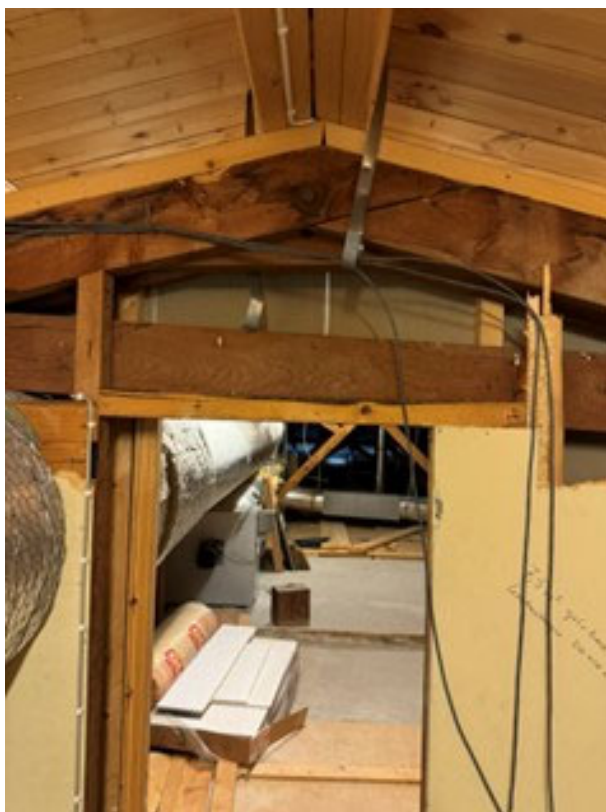
Bilde 7. Ventilasjonsanlegg på loft.
