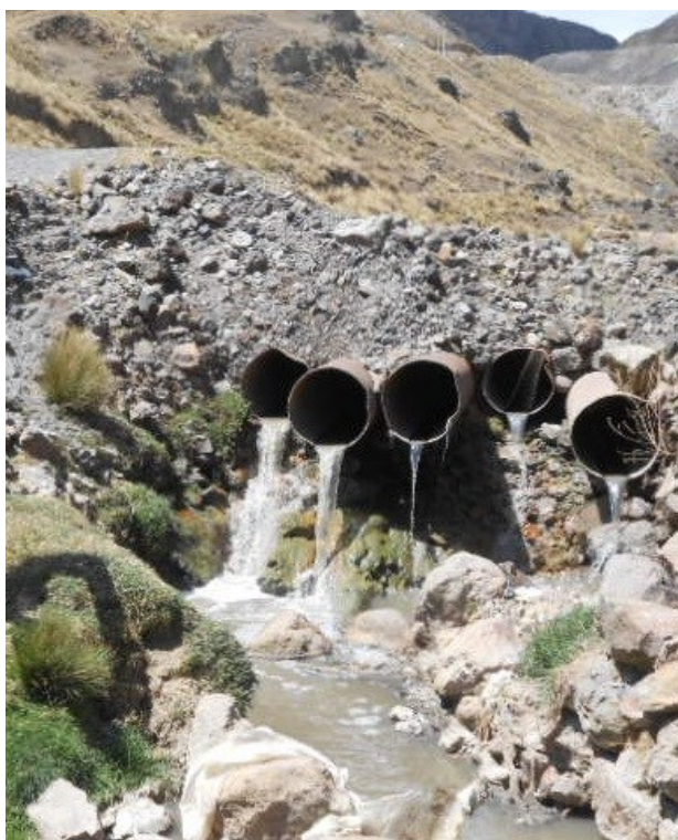
Río Tingo: contaminación por residuos sólidos urbanos y mineros
