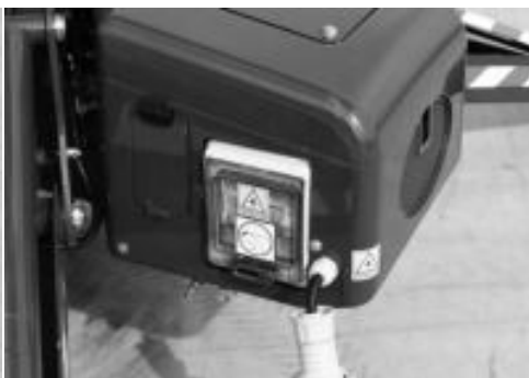
Fig. 148 Automatische magnetothermische schakelaar
