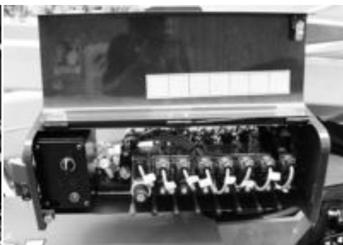
Fig. 58 Hydraulische bedieningen aan de grond
