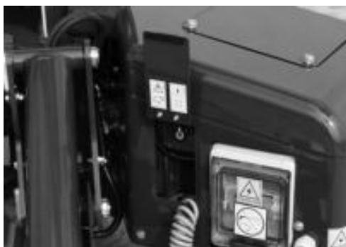
Fig. 127 Aansluitdoos in ruimte met elektrische componenten.
