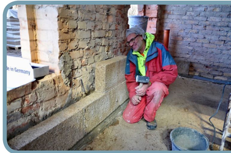
Der Raum zwischen Bestandswand und Vorsatzschale wird mit Hanfkalk-Trockenschüttung (Stein-Verschnitt und gecoatete Schäben) gefüllt. © Klimapraxis
