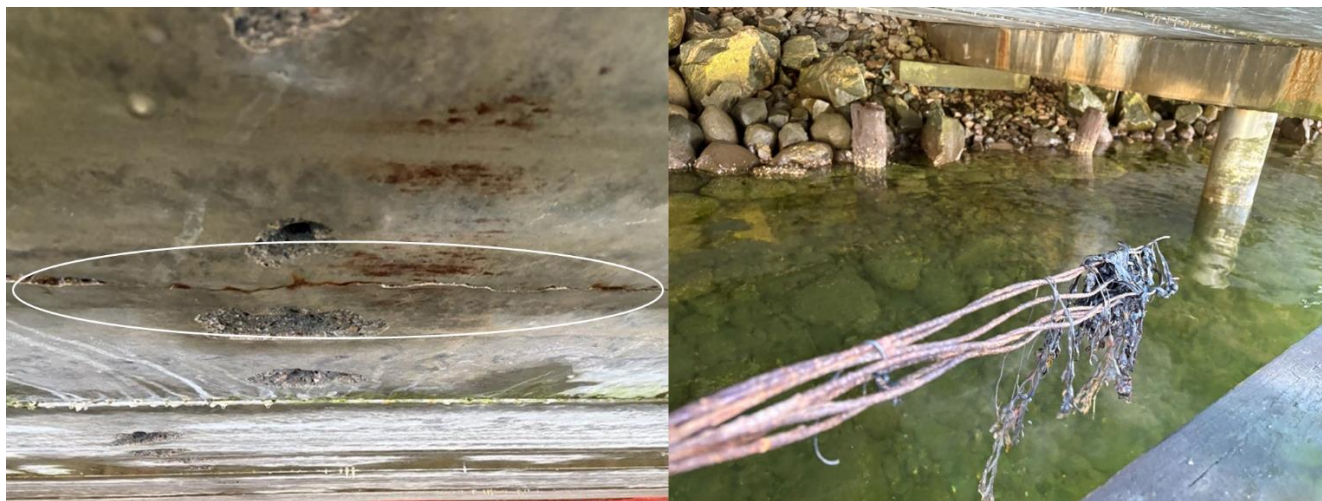
Figur 3: Venstre: eksempel på langsgående riss i underkant av hulldekke-element. Høyre: eksempel på brudd i ytterste spenntau i ytterste element.
