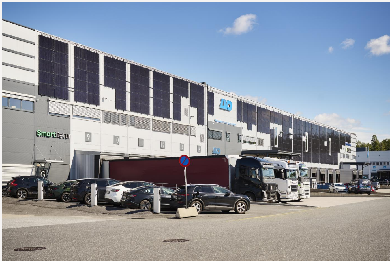
Solcelleanlegget på fasaden til Fugleåsen 10-12-14.
