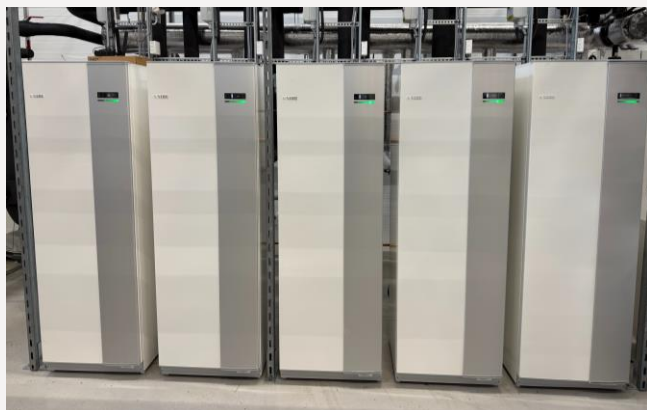
Solcelleanlegget og varmepumpesentralen på Toveien 28.
