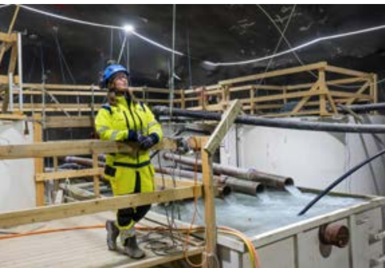
– Alt prosessvann fra tunneldrivingen går gjennom dette rensanlegget før det slippes ut i sjøen. Vi følger målingene nøye, og resultatene er gode, forteller YM-leder Elizabeth Paulen.
