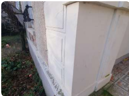
Peinture qui cloque à cause des remontées capillaires
