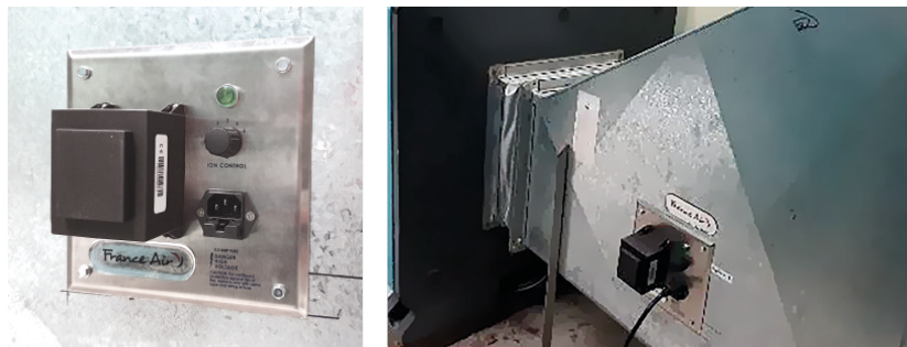
Instalación en el lado de la insuflación de aire en la red
