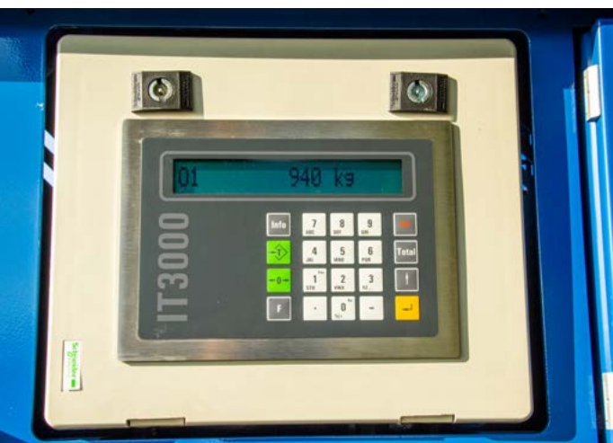
Display in der Schaltwand
