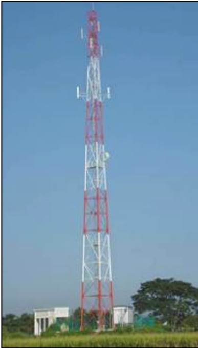
3-Legged Tower (Tubular Type)
