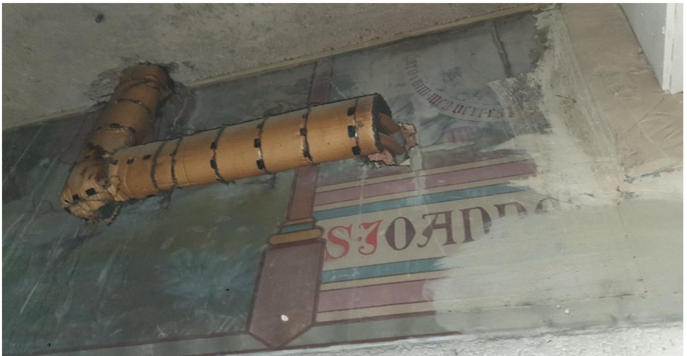
Achter het verlaagde plafond in de kleedkamers is te zien hoe de nieuwe vloerplaat en kanalen door de wandschilderingen getrokken zijn. Er werd zelfs over een gedeelte van de schilderingen zonder reden geplamuurd. Dit illustreert perfect de naoorlogse modernistische tijdsgeest waarbij men neerkeek op deze voor hen oubollige vooroorlogse architectuur.
