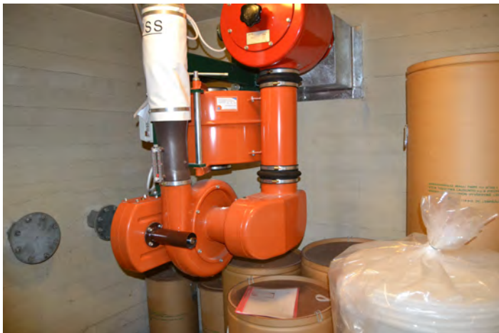
Väestönsuojan ilmanottoalaite ja varavesisäiliöt ja kuivakäymälät
