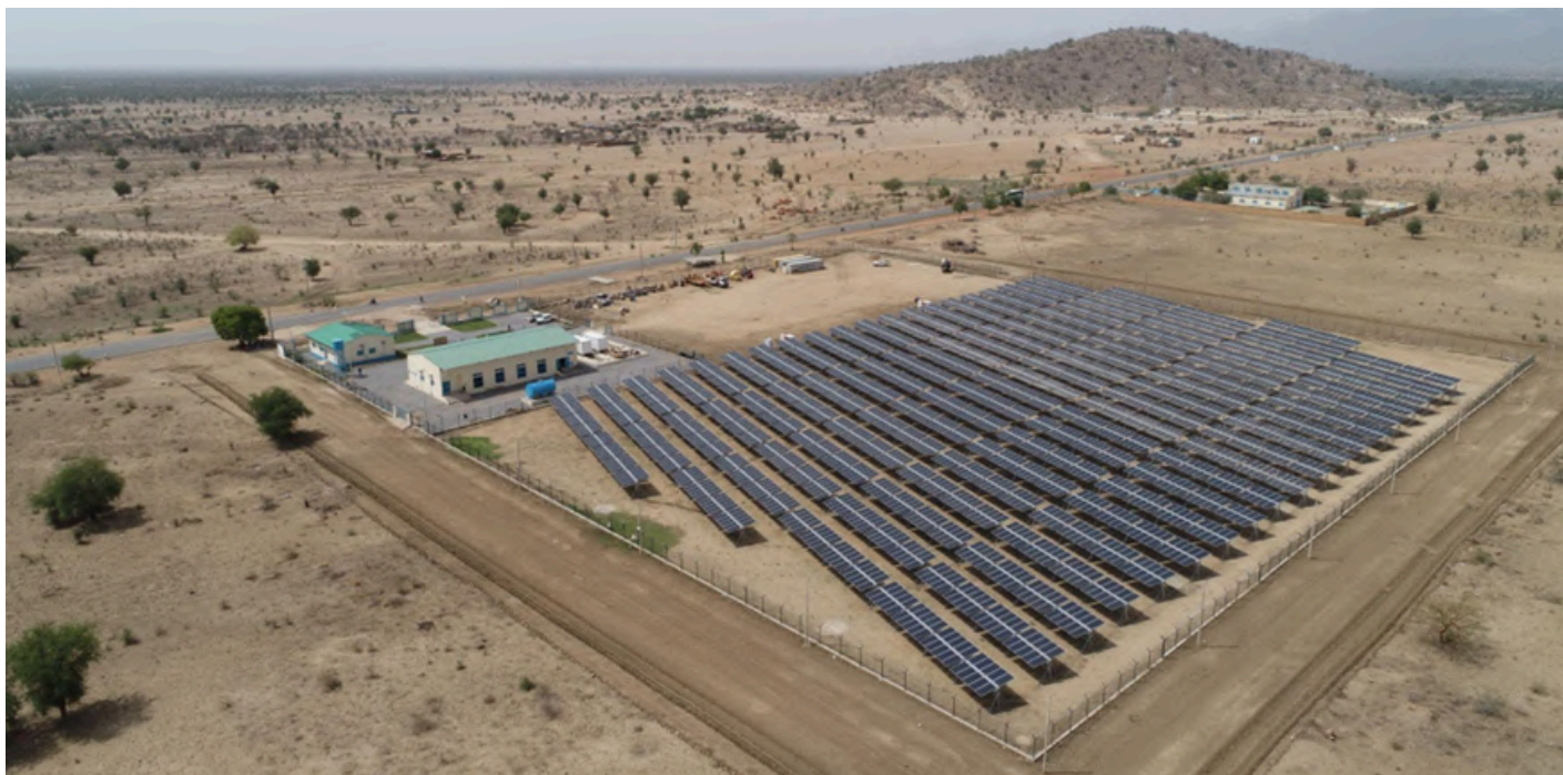
Fig. 12 – Vue aérienne de la centrale solaire hors réseau de la ville de Mongo au Tchad en 2023. Cette centrale photovoltaïque de 2 MW, équipée de batteries et d'un générateur diesel de secours (bâtiments techniques sur la gauche), permet de fournir quelque 3300 foyers en électricité. Image : ZIZ Energie.
