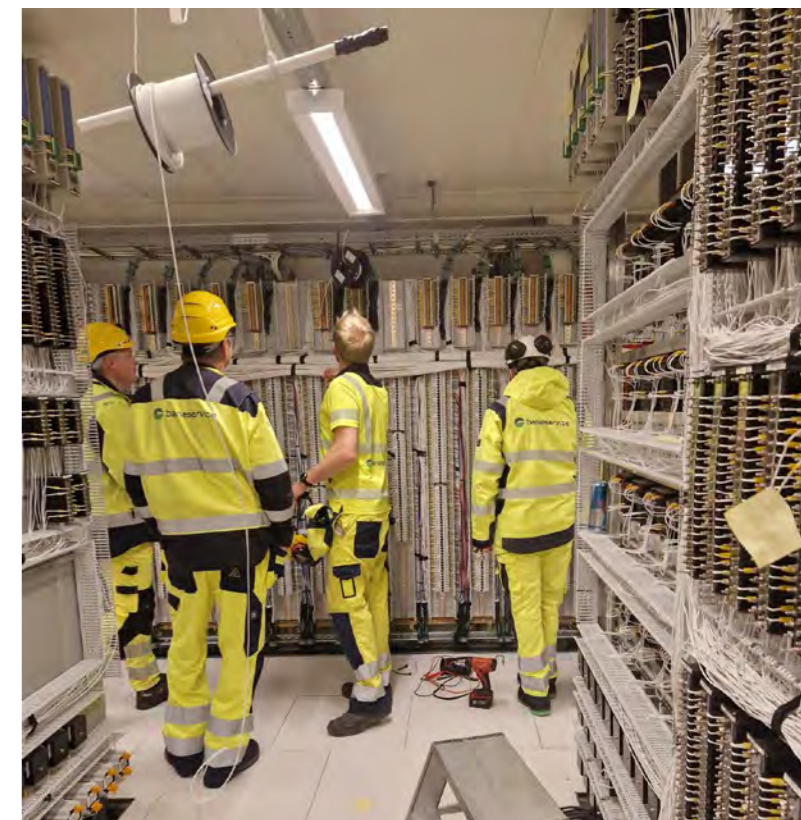
Ingeniørtjenester besøker det nye relérommet på DUK-prosjektet i Drammen.
