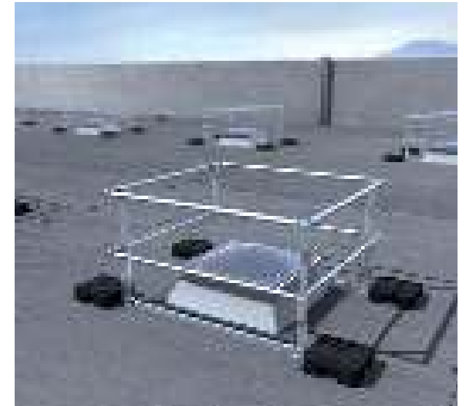
Gefahrenstelle Oberlicht mit Kollektivschutz
