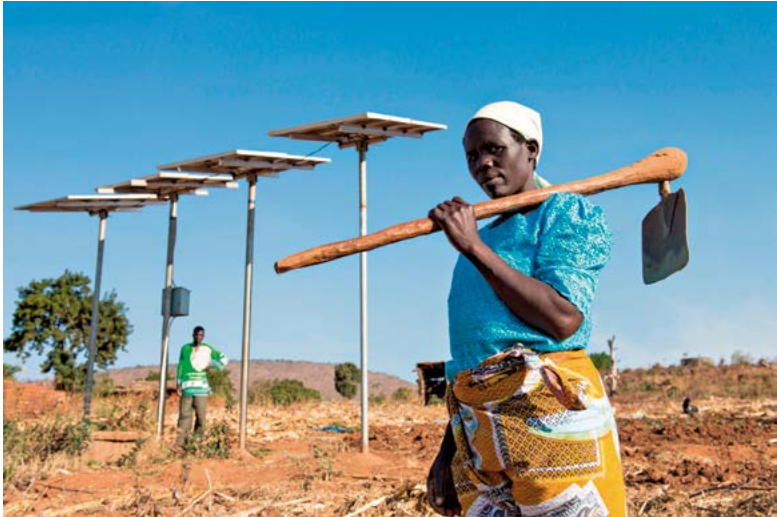
Pompe à eau solaire, servant à l'irrigation et à l'approvisionnement en eau du village de Zingiziwa, au Malawi.
