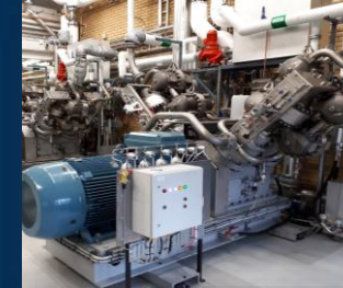
El installasjon varmepumper industri
