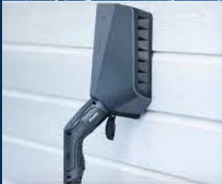
Montering av El-billadere
