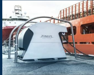
Installasjon i forbindelse med landstrøm til skip
