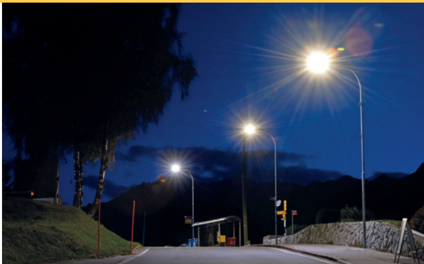
Les nouveaux luminaires LED sont gérés à distance grâce à un système de télégestion.
