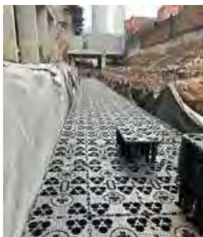
Vivaz Cyrela Vila Nova Cachoeirinha instalou um tanque de retardo e outro de aproveitamento da água de chuva
