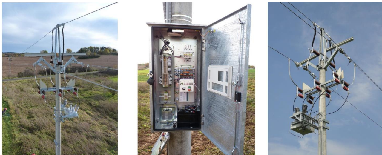
Obrázek 2: Detailní pohled na recloser
