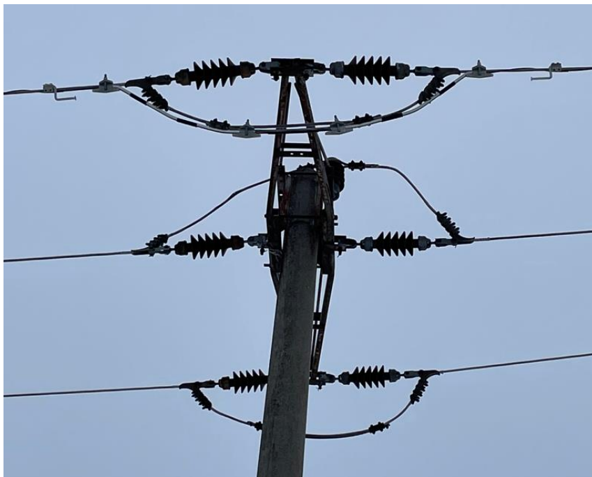
Obr. 8 – Zkratovací růžky na vedení
