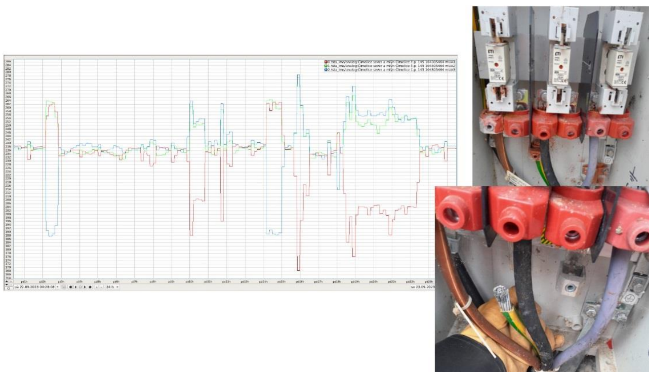
Obrázek 11: Porucha proudového spoje
