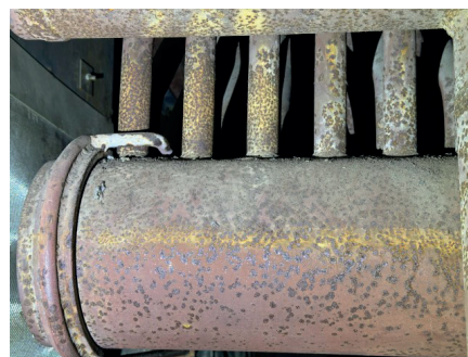
Figure 2. Corrosion of HRSG pressure parts
