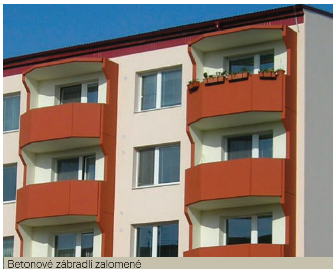
Betonové zábradlí zalomené
