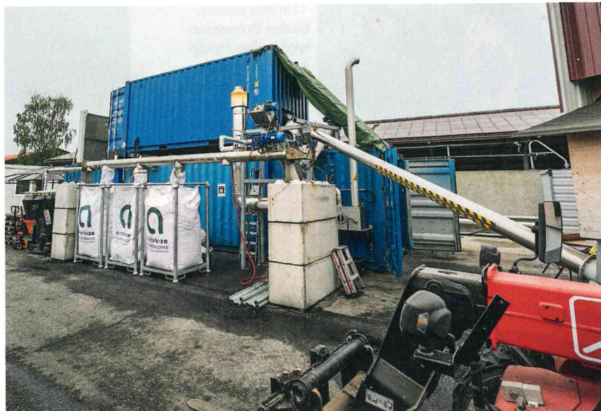
△ Eine Schnecke fördert die Biomasse aus einem Bunker in die Anlage. Das Endprodukt, die Pflanzenkohle, wird in Big Bags aufgefangen.
