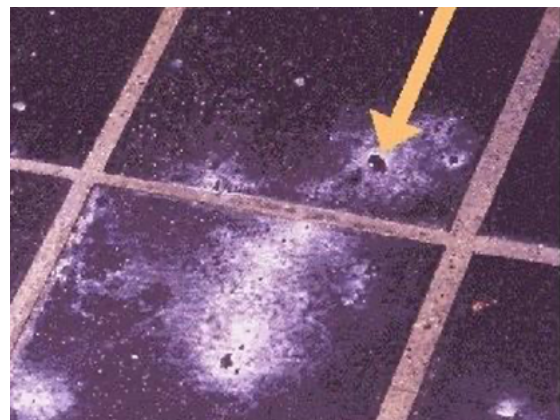
Bilde 6 : Et typisk tilfelle på alkalireaksjoner med overflateavskallinger og utfellinger på flisoverflaten
