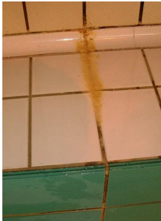
Bilde 7: Påstøp oppå underliggende membran medfører risiko for kalkutfellinger. Jo høyere temperaturer i vann og luft dess mer forsterkes denne effekten da vannet lettere kommer ut av karbonatbalanse og utfellingene dannes. Slike kalkutfellinger opptrer der fukt transporteres via påstøp og lim og vandrer ut via fugene. Vannet fordampes, og kalkutfellinger samler seg. Utfellingene kan løses opp og fjernes med syreholdige kjemikalier, men kommer ofte raskt igjen.
