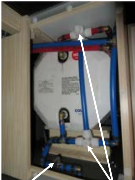
1 2 PHOTO D-7 Valve de vidange et valves de déviation
