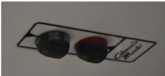
PHOTO F-7 Thermostat et boutons de contrôle
