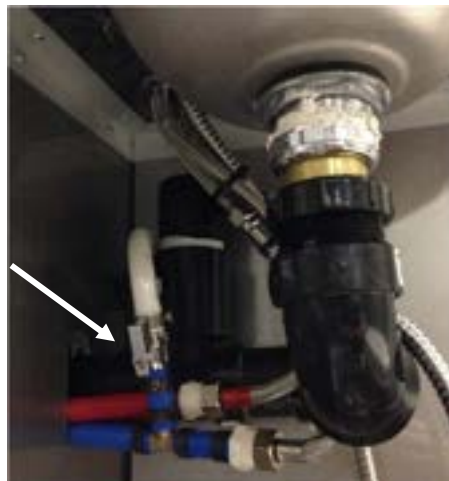
PHOTO G-7 Valve de plomberie
