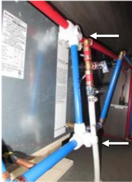
PHOTO D-9 Valves de déviation A et B ( bypass )
