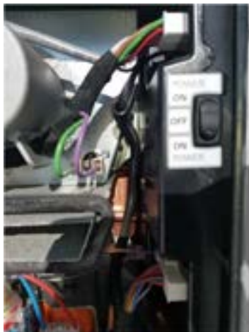
PHOTO D-12 Interrupteur du chauffe-eau Aquago
