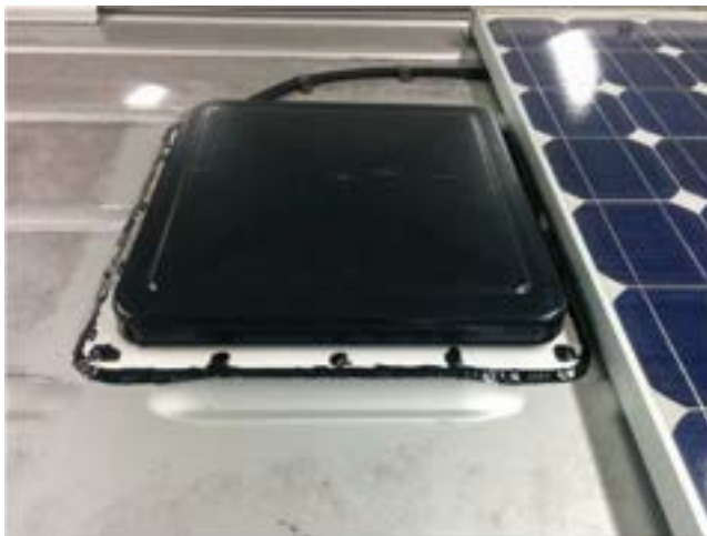
PHOTO G-1 Joints d'étanchéité du ventilateur de toit
