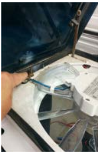
PHOTO F-5 Interrupteur extérieur du ventilateur
