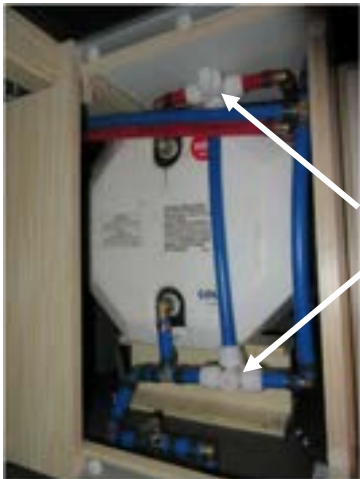
PHOTO G-4 Valves d'hivernisation (chauffe-eau au propane)
