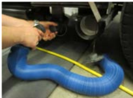
PHOTO D-31 Raccord pour vidanger les eaux usées
