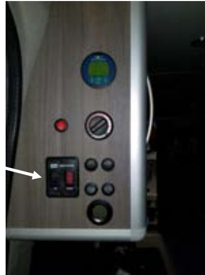
PHOTO D-6 Interrupteur du chauffe-eau propane 15 litres
