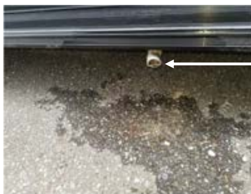
PHOTO E-67 Tuyau d'échappement de combustion du chauffage à l'extérieur
