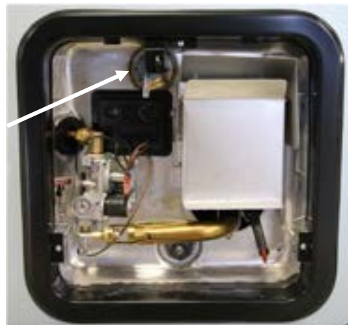
PHOTO D-8 Soupape de sécurité
