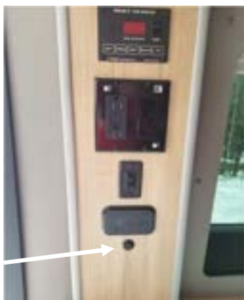
PHOTO E-42 Interrupteur pour lumière dans l'espace cargo
