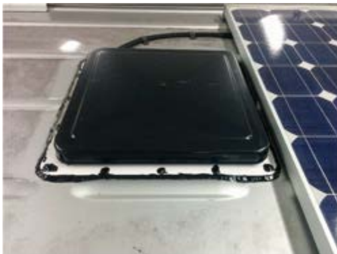
PHOTO F-6 Joints d'étanchéité du ventilateur de toit
