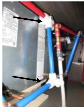
PHOTO G-5 Valves d'hivernisation (avec chauffe-eau Aquago )
