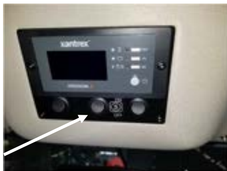
PHOTO E-61 Interrupteur chauffage situé au plafonnier
