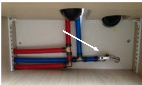
PHOTO G-6 Valve de plomberie
