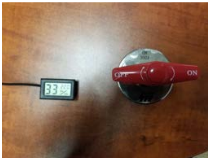
PHOTO C-4 Thermomètre et interrupteur de batteries
