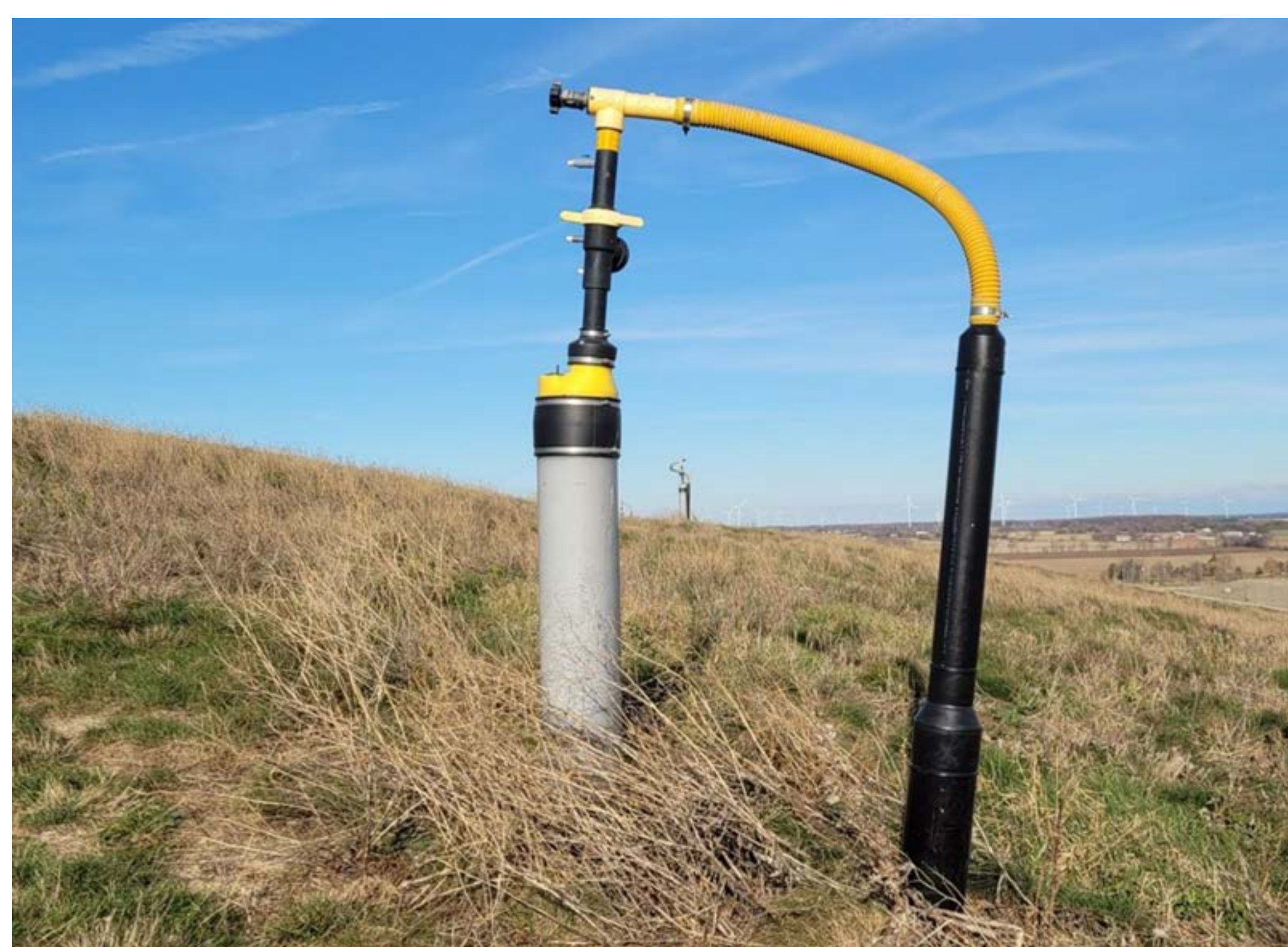
Puits de biogaz typique
