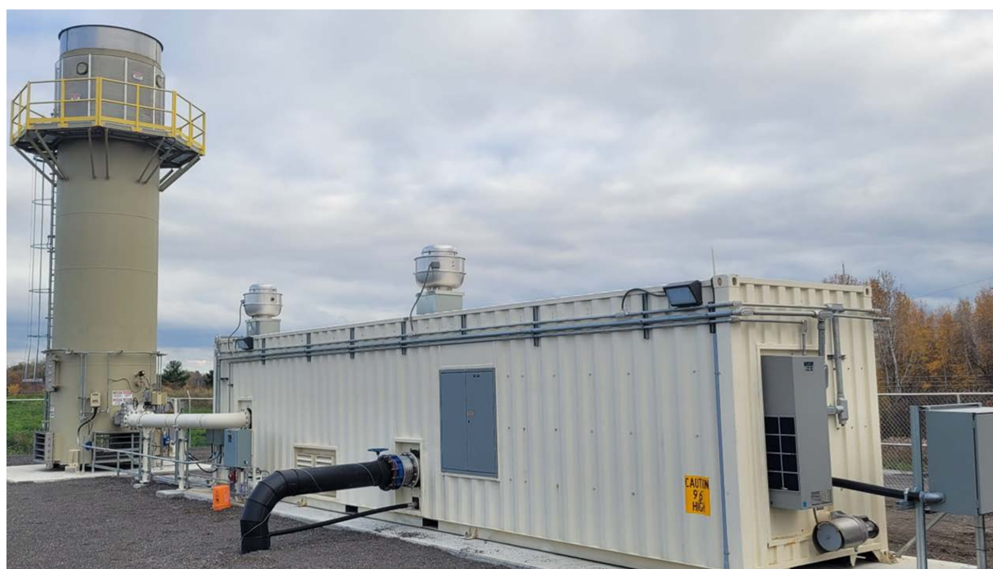
Installation d'extraction des biogaz et torchère fermée
