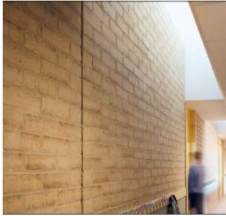
Fig 14 Exemple de joint de fractionnement, de retrait ou de dilatation dans une cloison en doublage d'une paroi structurelle
