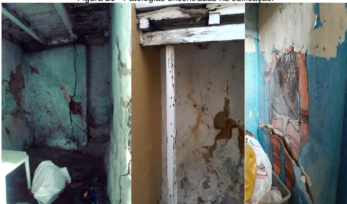
Figura 26 - Patologias encontradas na edificação.
