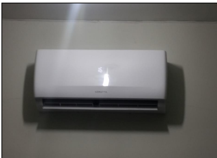
Figura 35. Ar condicionado do Setor de Engenharia com temperatura em 16°C
