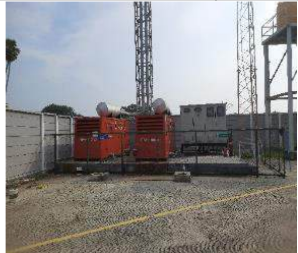
62) Diesel Generator Space
