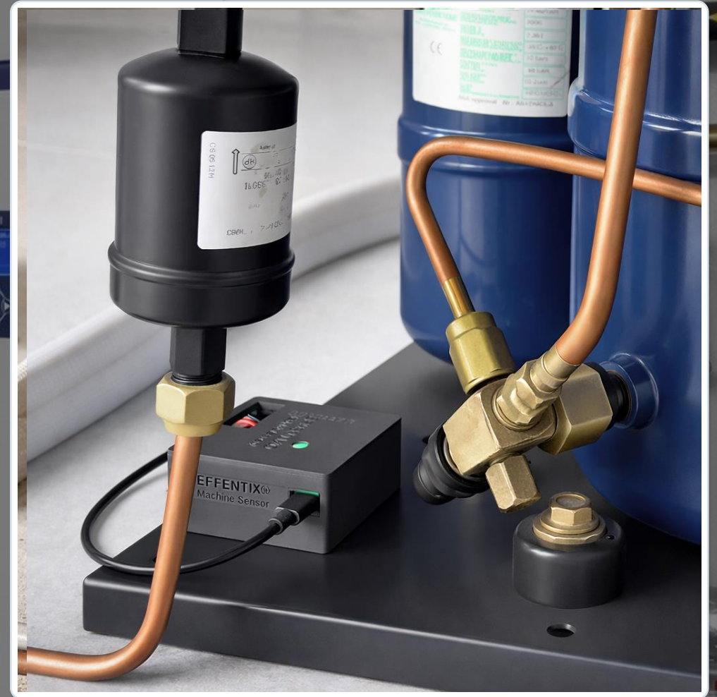
Beispielfoto: Sensor an zugänglicher Metallfläche in Verdichternähe
