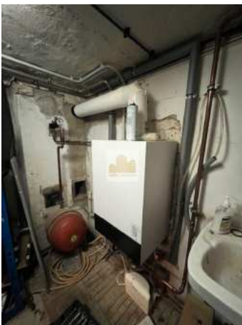
Gas Therme Kellerbereich
