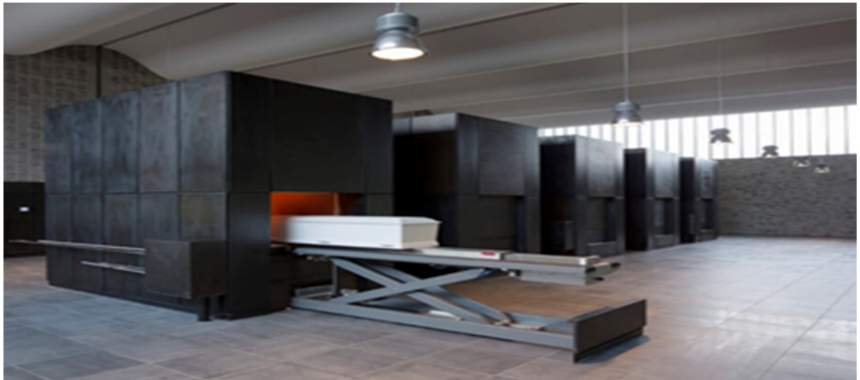
Figura 2 - Caldeiras - Crematório Comunal em Ringsted.
