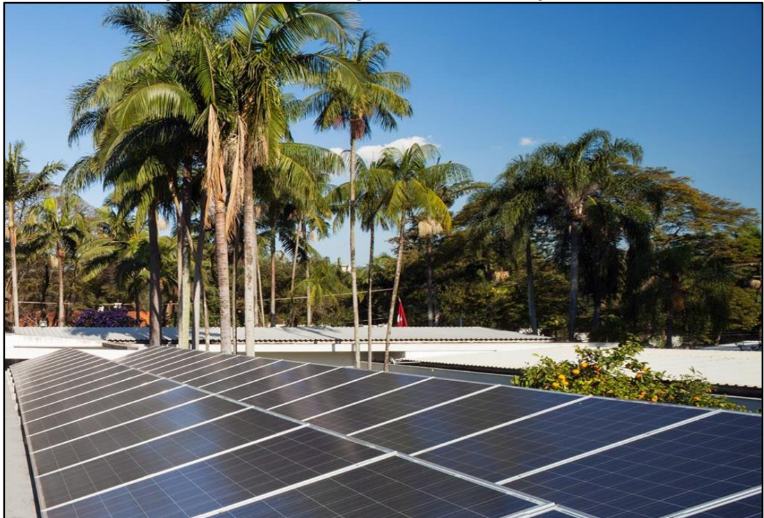
Figura 33 - Imagem área externa Residência Campo Belo/ Placas solares (GALERIA DA ARQUITETURA, 2016).
