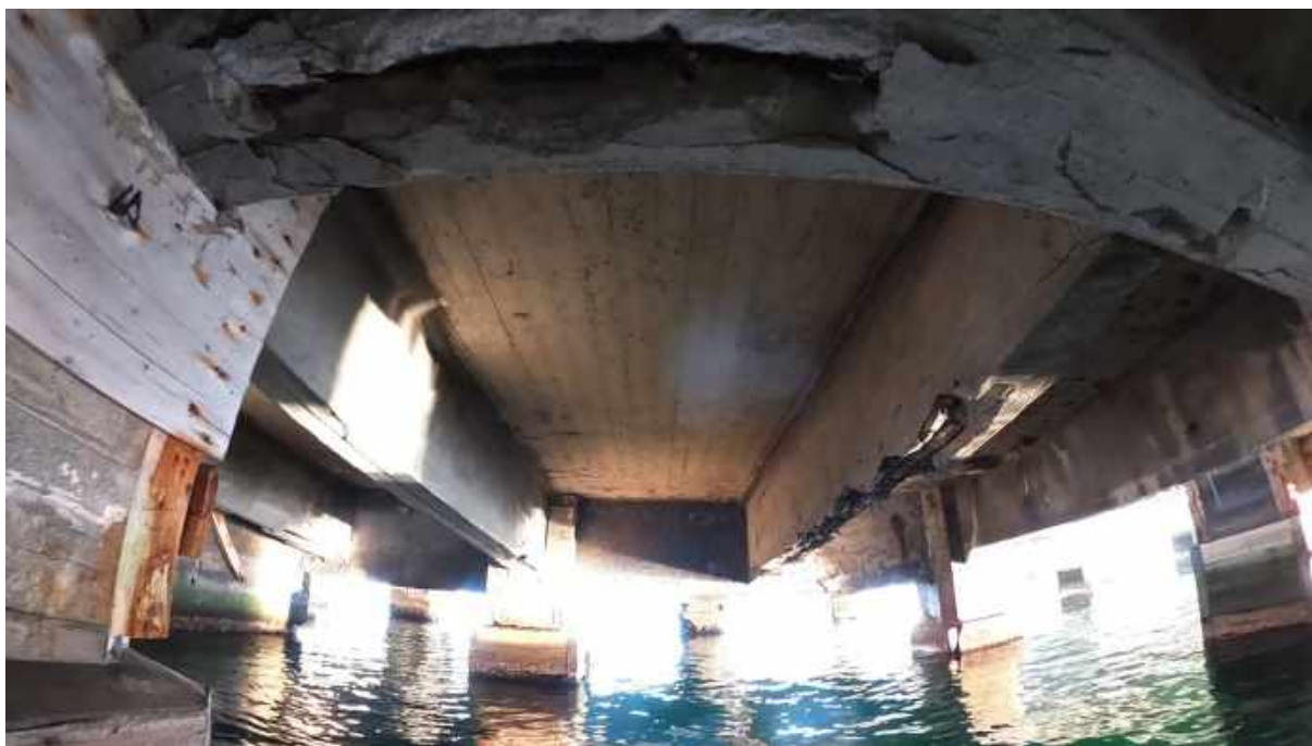
Figur 42: bygningsskader på Kai B
