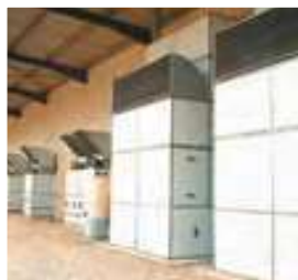
Ventilation répondant aux normes sanitaires et environnementales
