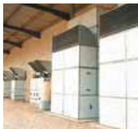
Ventilation répondant aux normes sanitaires et environnementales
