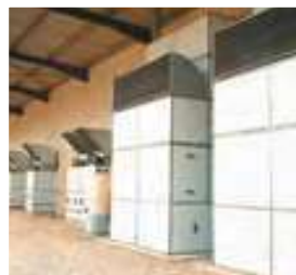
Ventilation répondant aux normes sanitaires et environnementales
