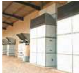
Ventilation répondant aux normes sanitaires et environnementales
