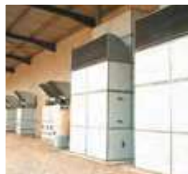
Ventilation répondant aux normes sanitaires et environnementales
