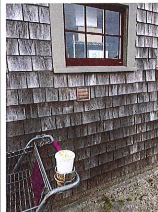
Toilet Room Exhaust Fan Louver
