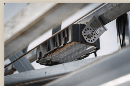
Verlichting in mast en giek (3x LED)
