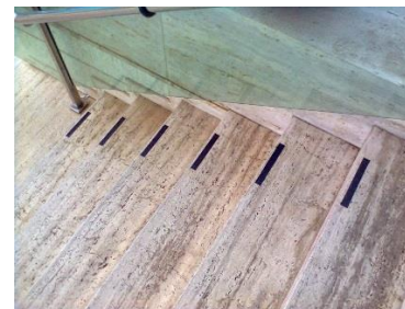
Escada com a Faixa de Sinalização de Degraus Fonte: Planeta Acessível
