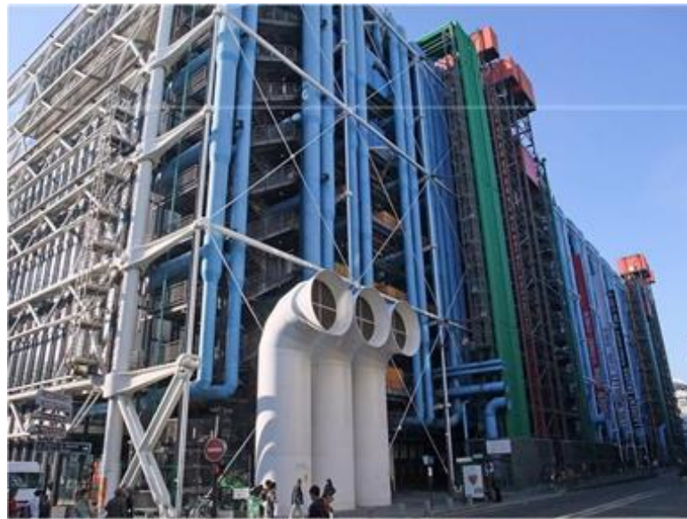
Detalhe das instalações Fonte: Flickrriver Marco La Rosa
