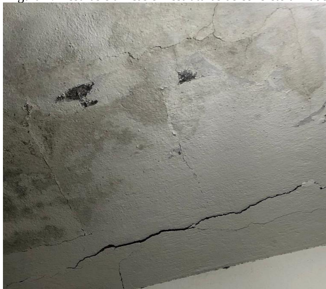
Figura 1: Fissuras e trincas em estruturas de concreto armado
