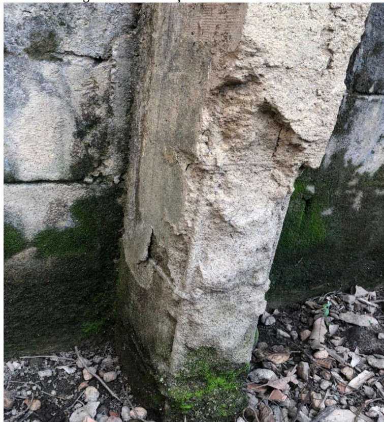
Figura 3: Deterioração da camada de concreto
