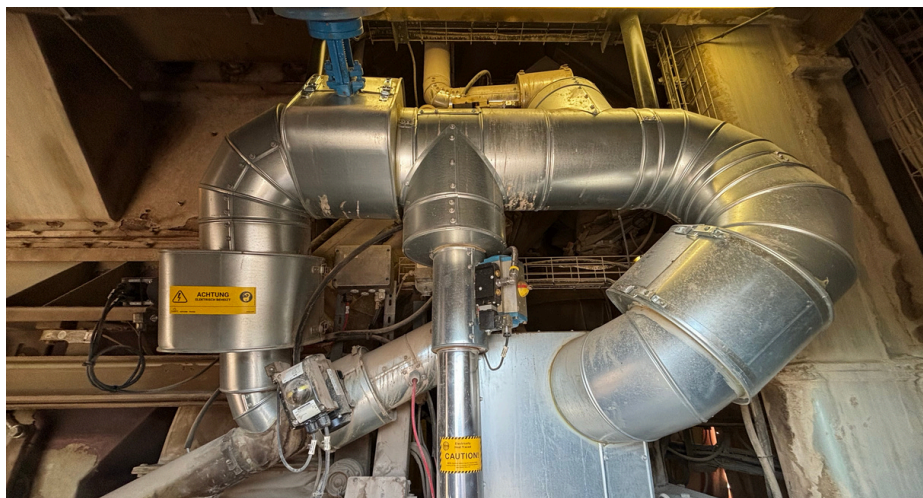
Seit 2025 in Betrieb die Schaumbitumenanlage zur Herstellung von Niedrigtemperatur-Asphalt (NTA)
