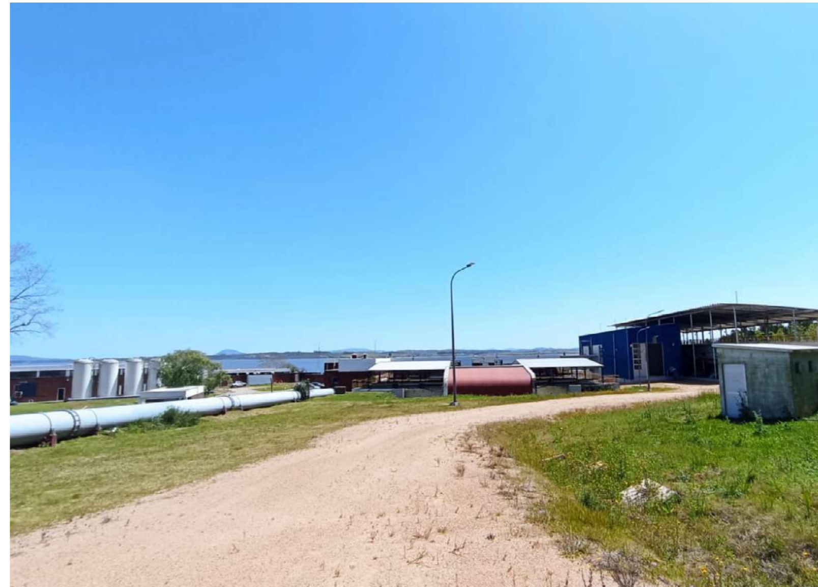
Planta potabilizadora localizada en la margen E de Laguna del Sauce.
