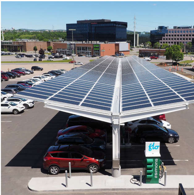
Ombrières solaires à Québec
