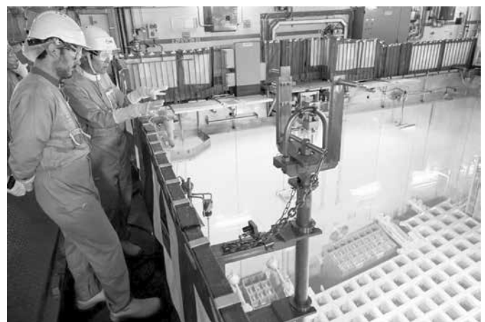
Dans la piscine de stockage du combustible usé, l'eau borée joue le rôle d'écran contre le rayonnement émis. Photo P.-Y. Royet
