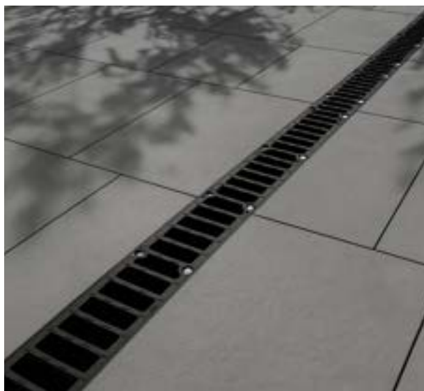
人行道排水溝
