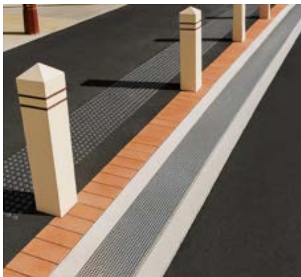
人行道排水溝
