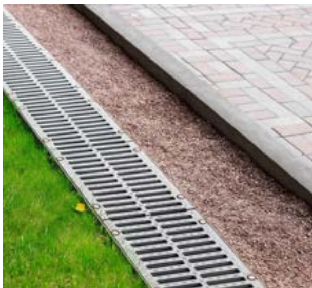
人行道排水溝
