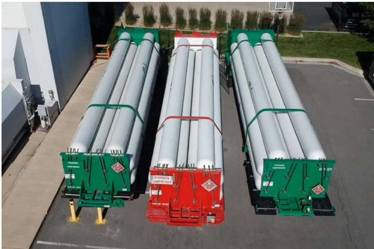
Figure 26 : Réservoirs à hydrogène placés à l'extérieur du data center Microsoft .
