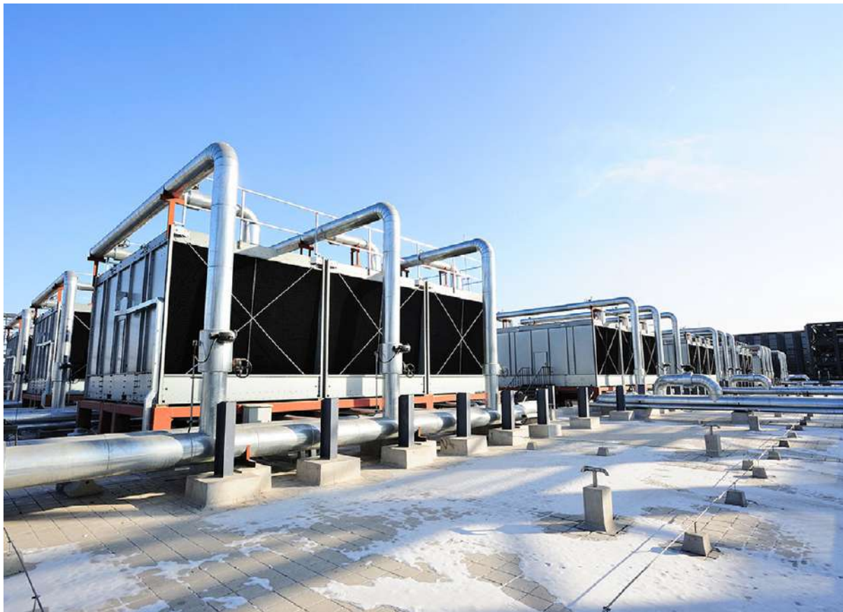
Figure 24 : Tours aéroréfrigérantes ( cooling towers )
